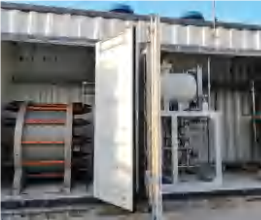
📍 凯豪达制氢加氢一体站
